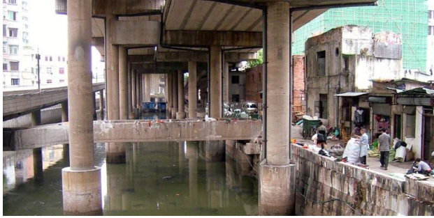
Canal Donghaochong avant la voie verte ; Crédit photo : Karl Fjellstrom/Far East BRT, Creative Commons Attribution License .
